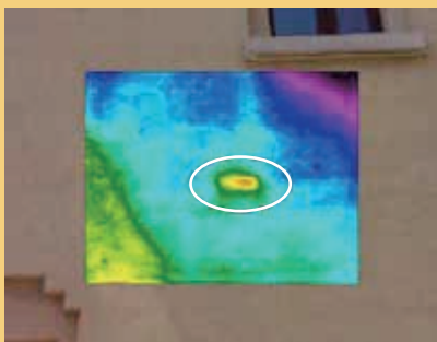
外牆空鼓，該位置在雨後極易滲水
