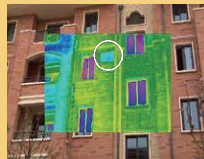
外牆維修後未填實，該處容易滲水
