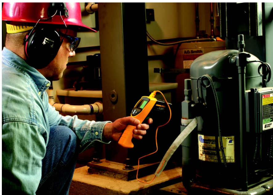
压缩机液态管出口的接触式温度测量。
