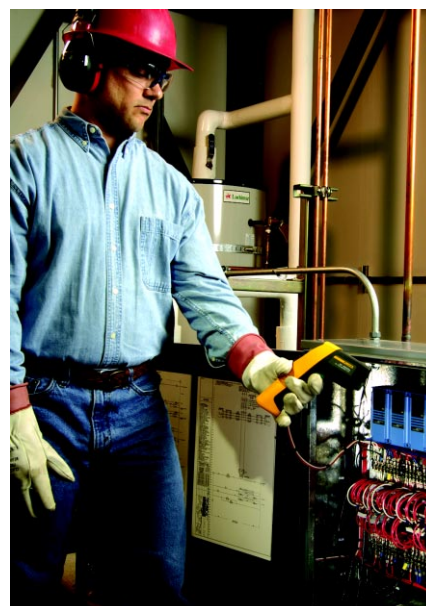
熔断器和电气连接温度测量。
